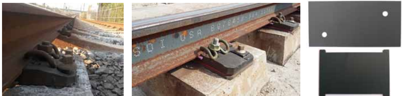
图 6: 扣件螺栓松动对无砟轨道造成损坏(左图)通过安装塑料补偿板和弹性轨下垫板解决该问题(中图,右图)
